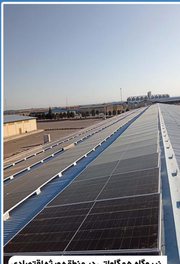
نیروگاه ۵ مگاواتی در منطقه ویژه اقتصادی سیرجان (بزرگترین پروژه نیروگاه سقفی در استان کرمان)
